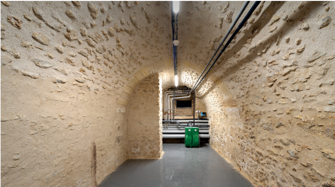
Espace technique au sous-sol de l'aile de Sceaux ©OPPIC - P. Tourneboeuf
