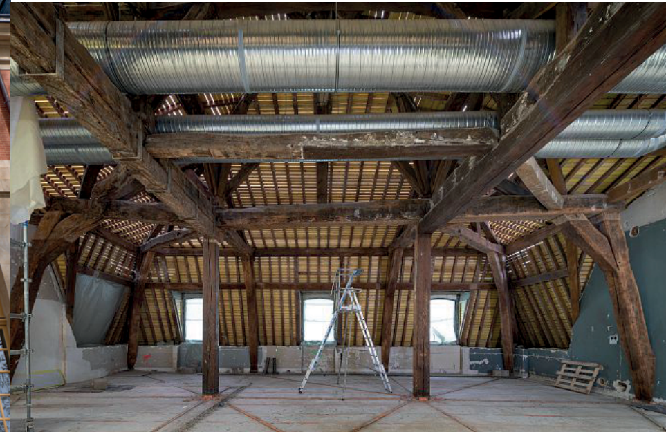
Réseau CVC, Pavillon de queue. ©OPPIC - P. Tourneboeuf
