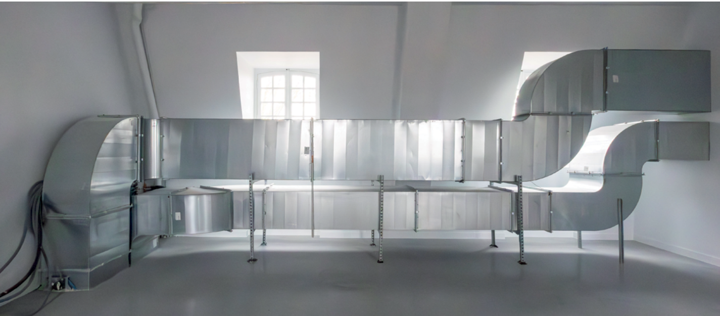
Système d'aération, aile de Sceaux ©OPPIC - P. Tourneboeuf
